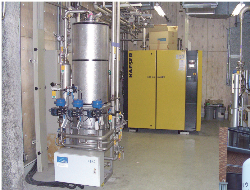
写真2 液化圧縮機（奥、黄色）及び油分離器（手前、銀色）
