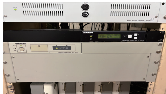
写真1 放送設備ラックに組み込まれた送信用ネットワークオーディオユニット AS-AU100 LCDパネルを有しているものがネットワークオーディオユニット。左横のブラックパネルの裏側に音圧感知リレーが固定されている。
