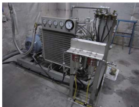
写真4 回収圧縮機 処理量50 m 3
