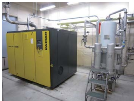
写真2 液化用圧縮機と油分離器
