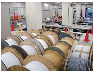
床下に配線される電源ケーブル。これでも半分です。
