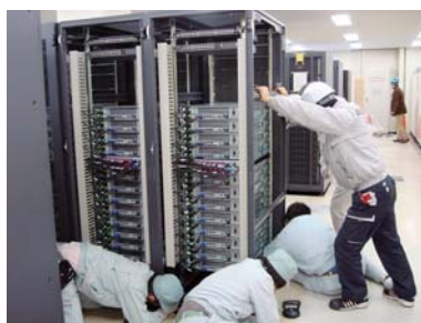
設置時には多くの作業員が力を合わせて1ラックずつ接続します
